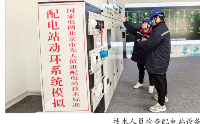
技术人员检查配电站设备
