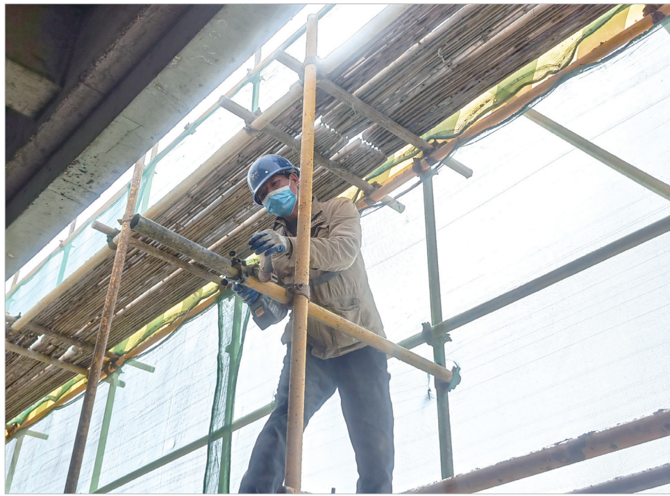
苗老吉生命健康科技创新园建设现场，工人拆除外围钢筋架。
