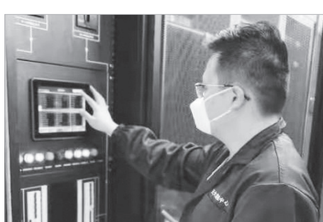
运维人员巡检机房
