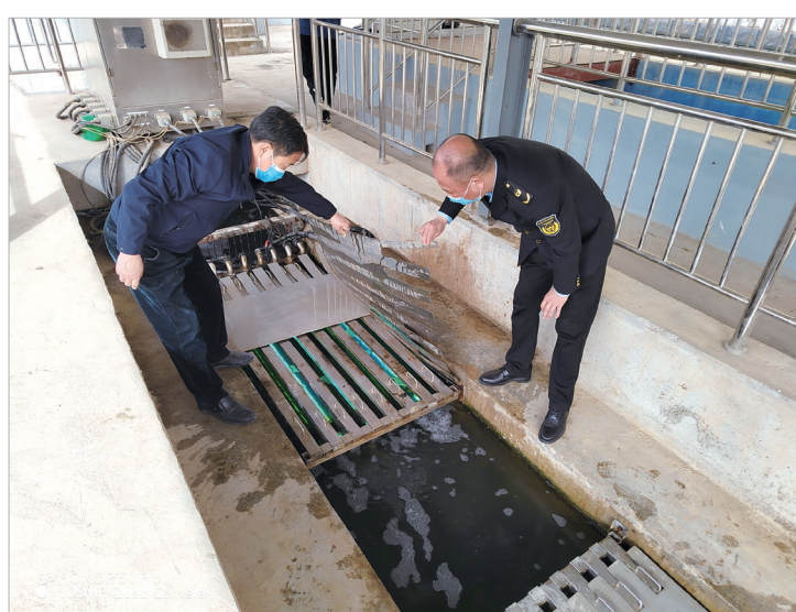
工作人员在扶风县百合污水处理厂检查生活污水紫外线消毒情况
