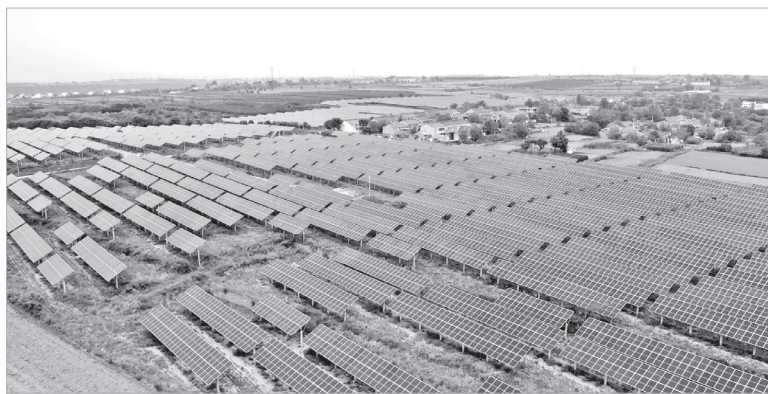
胜利村集中式光伏电站
