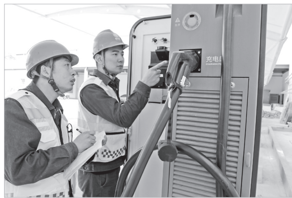
供电职工巡视检查充电桩
