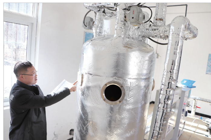
桃川镇杨下水厂对供水设备采取了防冻措施
