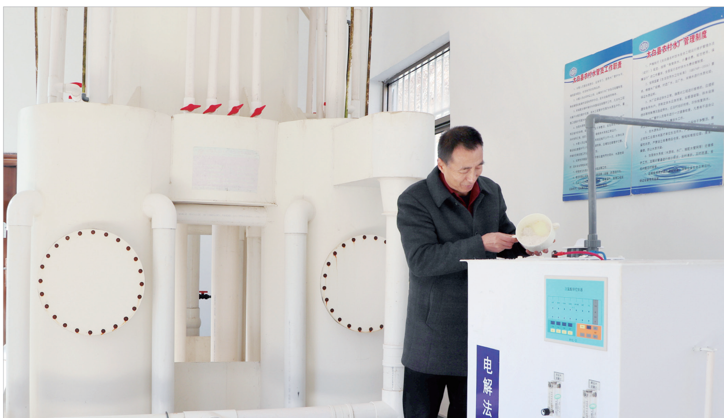
桃川镇灵丹庙水厂的自动化净水设备
