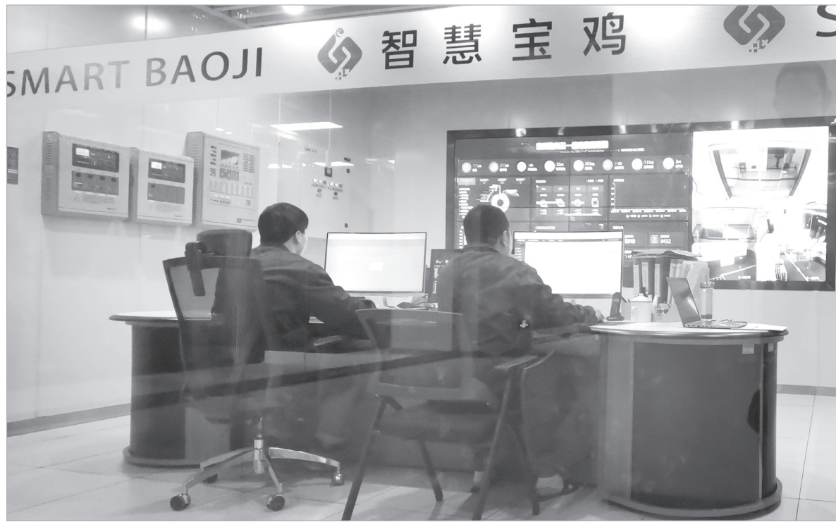
运维人员监控大数据中心政务云运行情况
