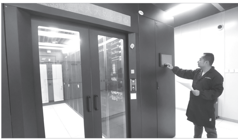
关天大数据中心运维人员巡检机房
