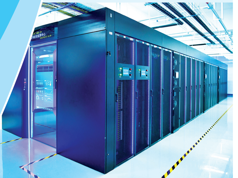
视觉超算中心机房一角
