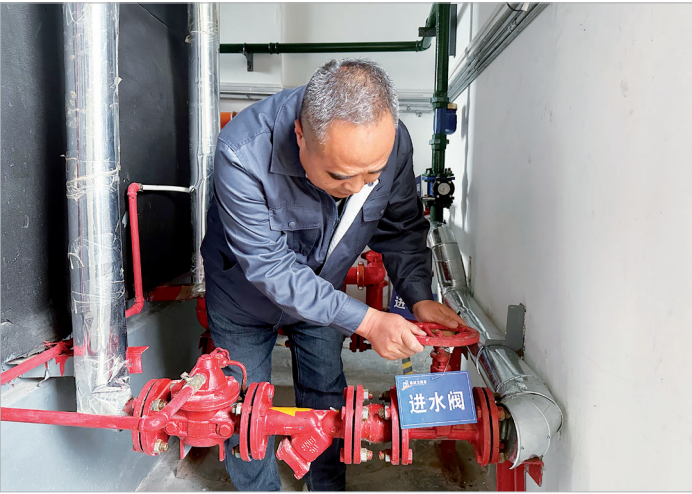
物业人员检查居民楼的用水安全
