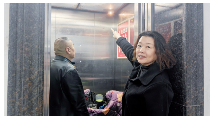
社区工作人员介绍电梯内安装的智能阻车系统
