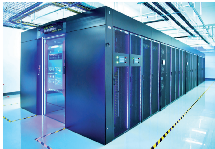
宝鸡视觉超算中心机房
