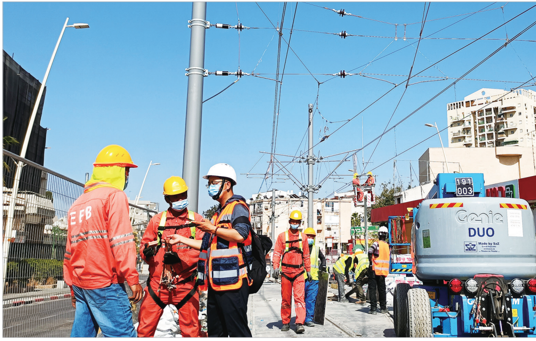
中铁高铁电气技术人员在现场施工（资料图） 中铁高铁电气提供
