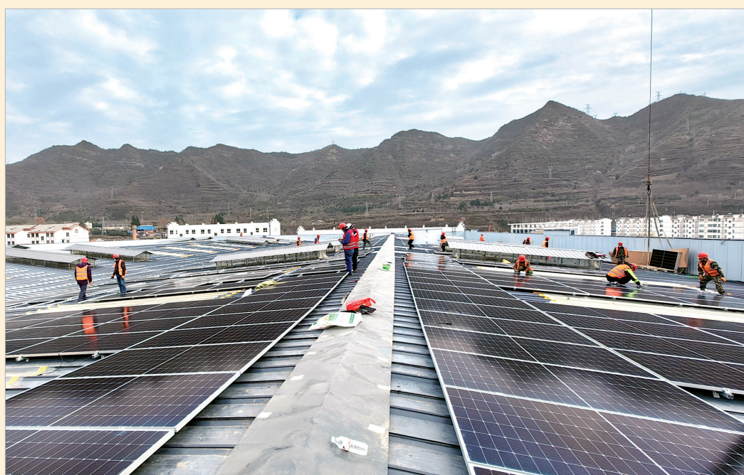
并网发电前,工人们要对设备进行最后的调试。
