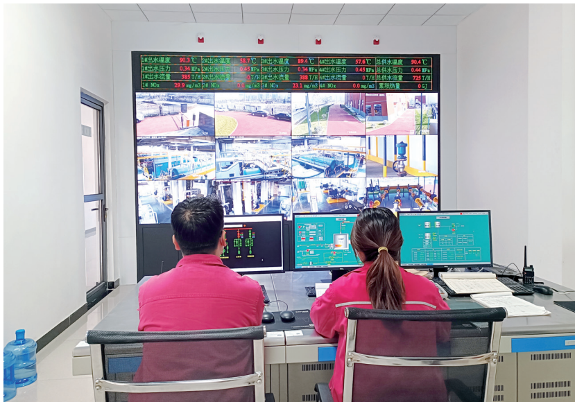
高新二路燃气热源站,工作人员通过大屏幕实时查看供暖情况。
