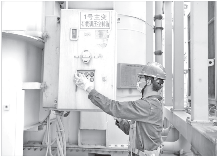
工作人员对马营变电站1号主变进行检测
